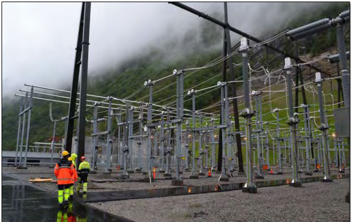
Figur 7. Eksempel på 420 kV apparatanlegg.
